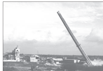
Da skorstenen faldt. Foto: Leif Lucas
